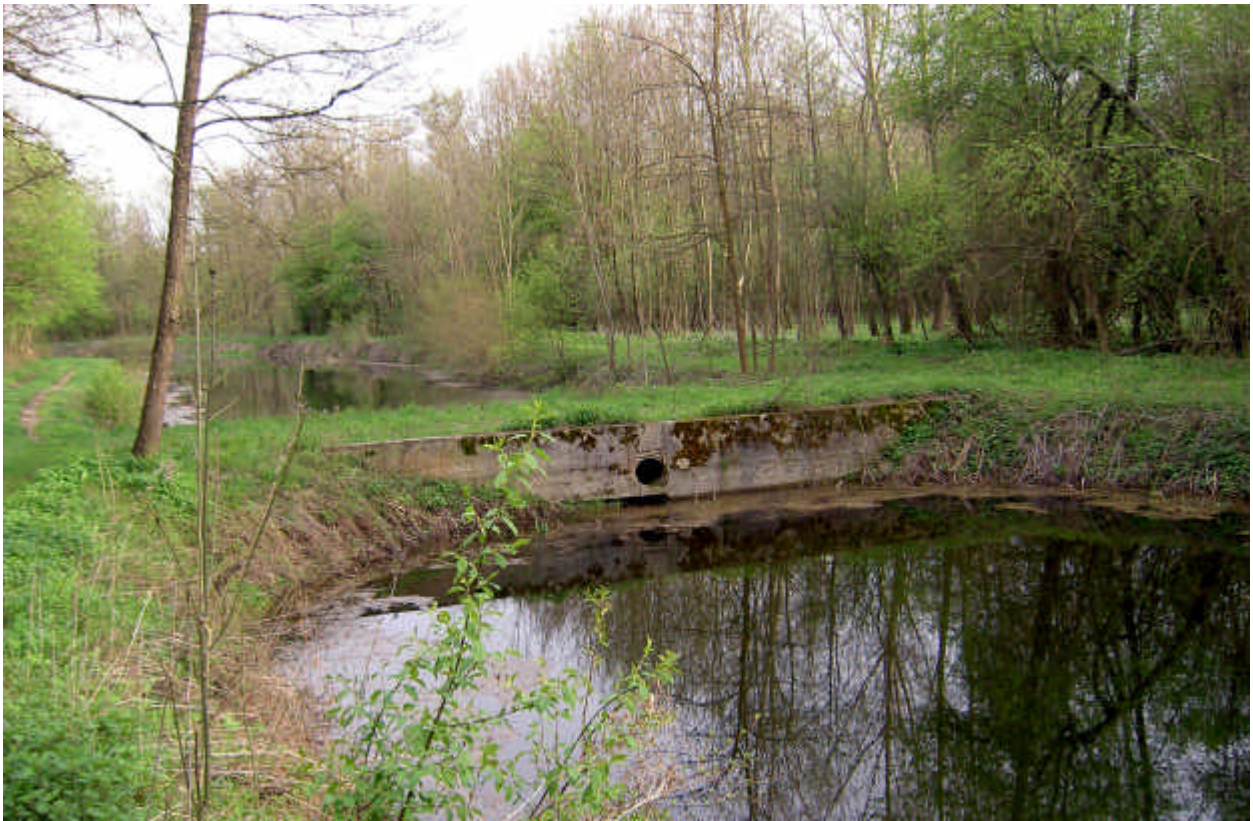
Abbildung 12-11: Rohrdurchlass, der den Oberen Teich (Vordergrund) bei Hochwasser mit dem Fischteich (Hintergrund) verbindet.
