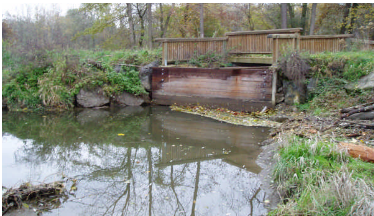
Abbildung 10-2: Drosselbauwerk am Ende des Abschnittes „Gnasbach“
