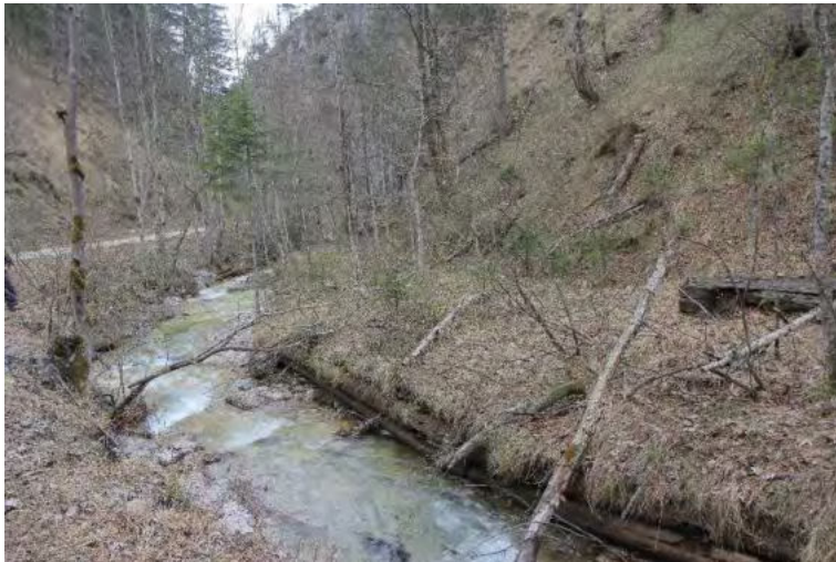
Abbildung 16. Mittels Krainer-Wand gesichertes rechtes Ufer im Bereich des geplanten Holzstegs. Reste des verfallenen Dicks rechts mittig.
